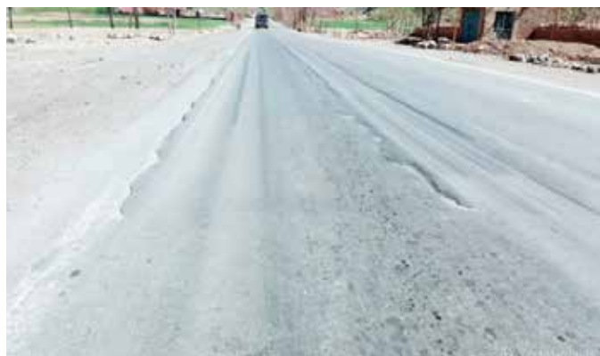
درزها در سطح سرک
