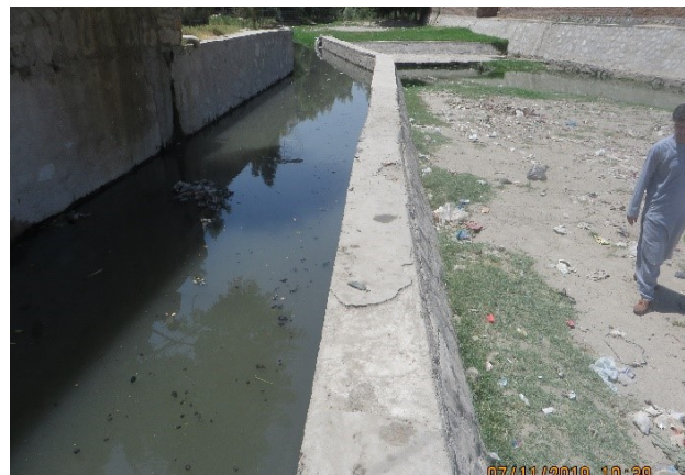
شکل 15: به ضخامت 15 سانتی‌متر کندی کانکریت بدون سیخ (ساده) بر روی قسمت C - C کانال دیده می‌شود که ممکن است در اثر عدم دقت در حفظ رطوبت کانکریت در طول ساخت‌وساز باشد.
