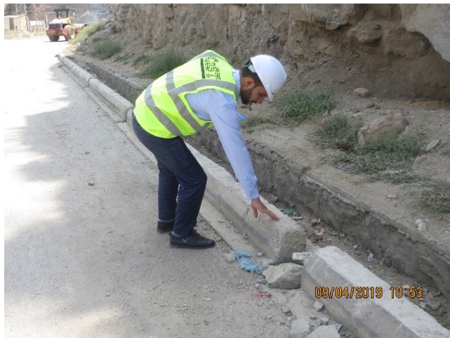
شکل 27: کندگی لایه‌های کانکریتی در سطح سنگ‌فرش‌ها مشاهده شده است.
