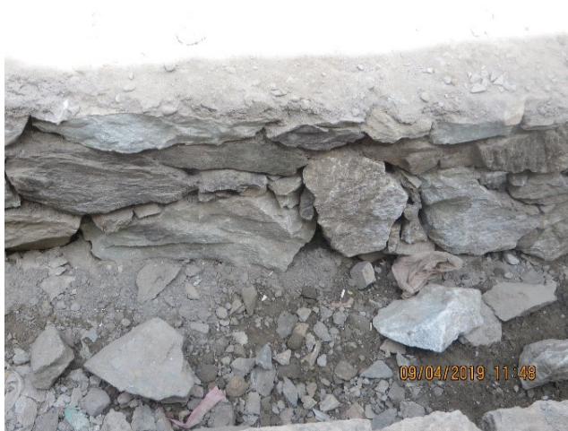
شکل 28: سنگ‌ها و سنگ‌کاری نامناسب در اعمار جوی‌های کنار سرک مشاهده شده است.
